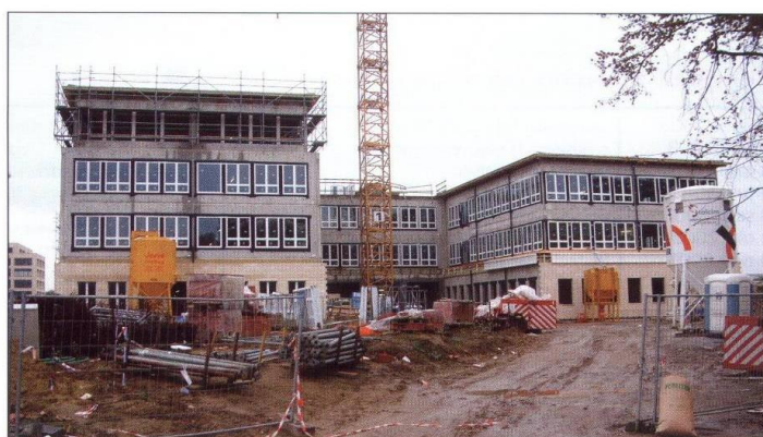
Het nieuwe politiekantoor op de Philips-site te Leuven krijgt thermische en akoestische vloerisolatie van Isolatietechniek Verhoeven uit Kamphenhout.
