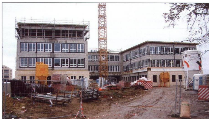
Het nieuwe politiekantoor op de Philips-site te Leuven krijgt thermische en akoestische vloerisolatie van Isolatietechniek Verhoeven uit Kampenhout.
